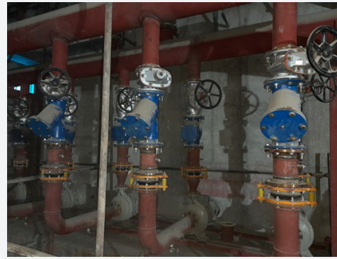
سیستم سیرکولاسیون مدار گرمایش موتورخانه مرکزی
