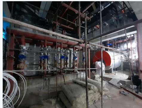
محل نصب دیگ های فولادی آبگرم و سیستم سیرکولاسیون گرمایش موتورخانه مرکزی
