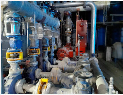
ایستگاه پمپاژ سیستم آبرسانی و آتش نشانی موتورخانه مرکزی
